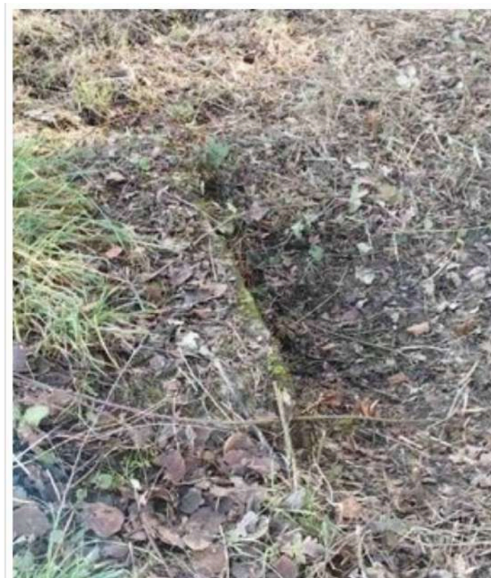
AVANT : Le nettoyage et curage du fossé situé sur la Grande Rue menant à Grand Courcelles a mis à jour un regard près du bosquet
