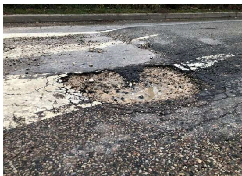
Réparation d'un nid de poule devant le dos d'âne situé Rue de l'Abbaye
